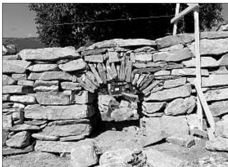
Besondere Raffinesse: Beim Neuaufbau dieser Mauer wurde selbst der ursprüngliche Rundbogen mitberücksichtigt.
