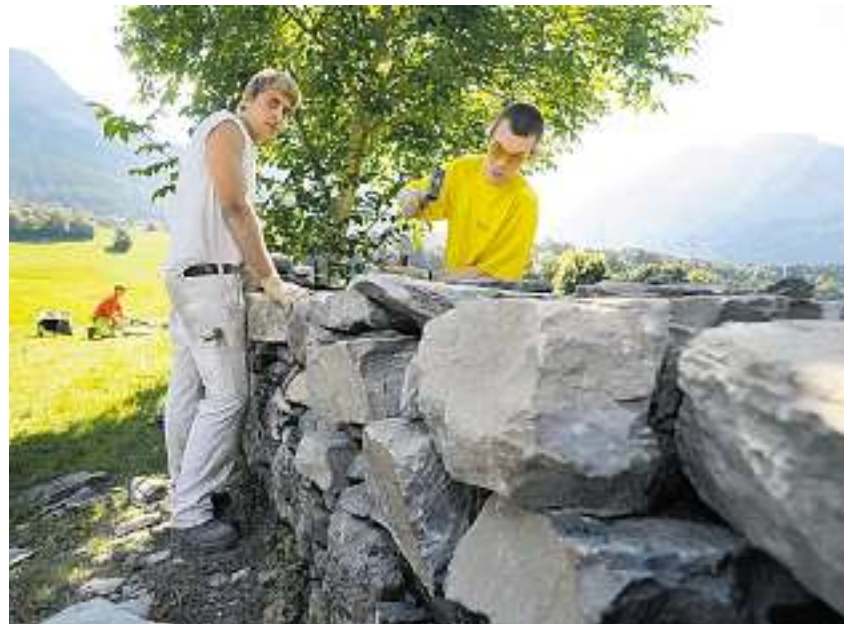
Keine einfache Aufgabe: Zwei Lehrlinge arbeiten am Wiederaufbau einer Trockensteinmauer in Fürstenua.
